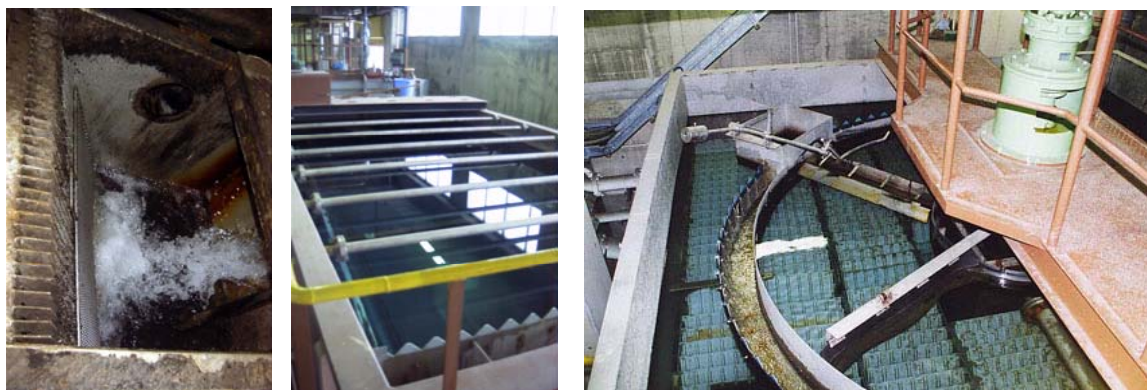
左から一般実験系の処理装置のスクリーン槽、沈殿槽（A系）、沈殿槽（B系）
